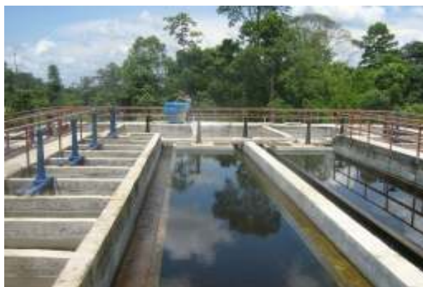
Planta de tratamiento de agua potable
