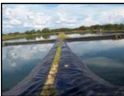
Foto 1. Sistema de tratamiento de agua residual
