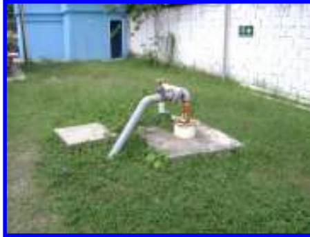
Fotografía 1. Pozo subterráneo, punto de captación, no cuenta con Concesión de aguas subterráneas.
