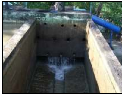
Fotografía 2. Sistema de desarenación
